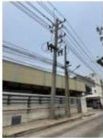
ภาพที่ 1 ก่อนการแก้ไข (ภาพจริง)
